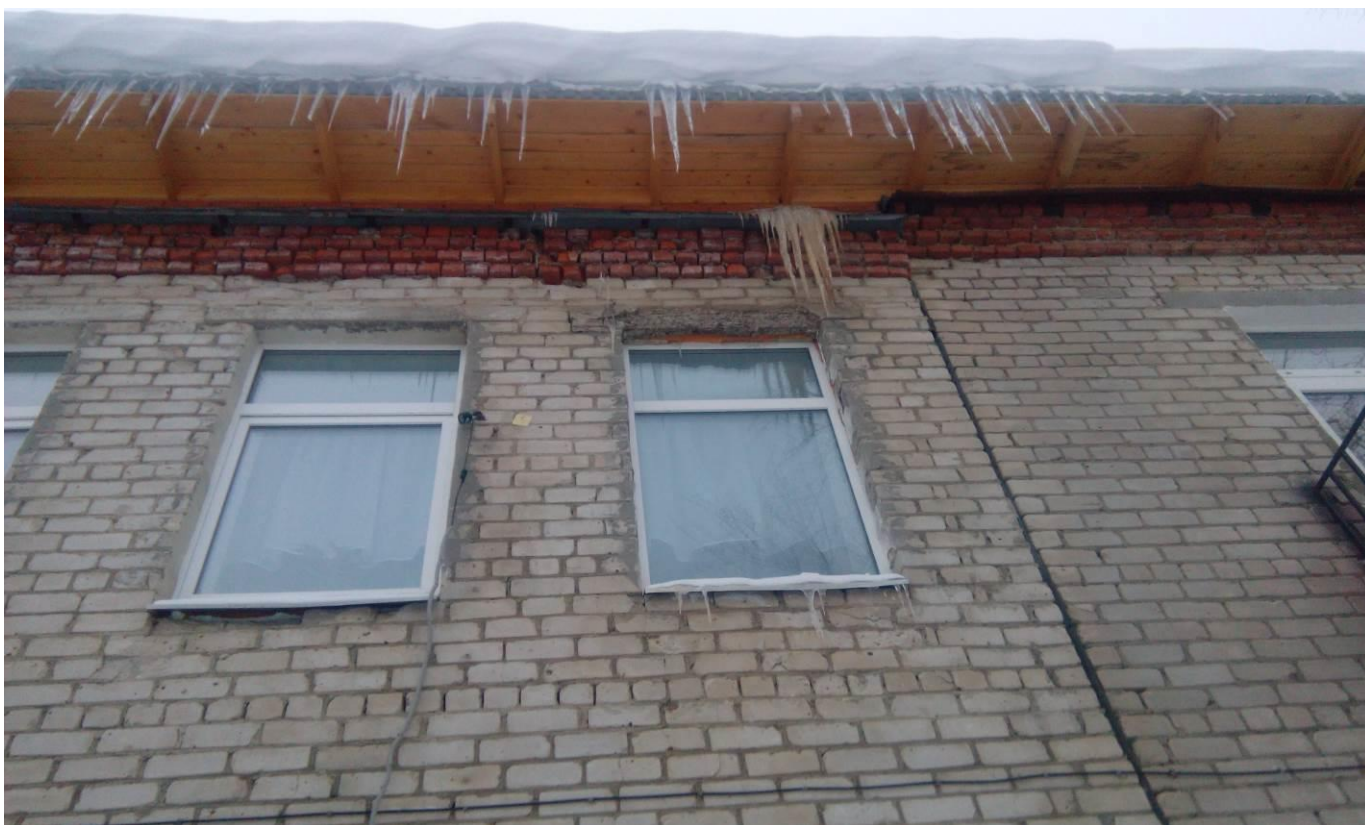
Фото 9. Замачивание наружной поверхности стены, разрушение бетона перемычки в осях В/4-3.
