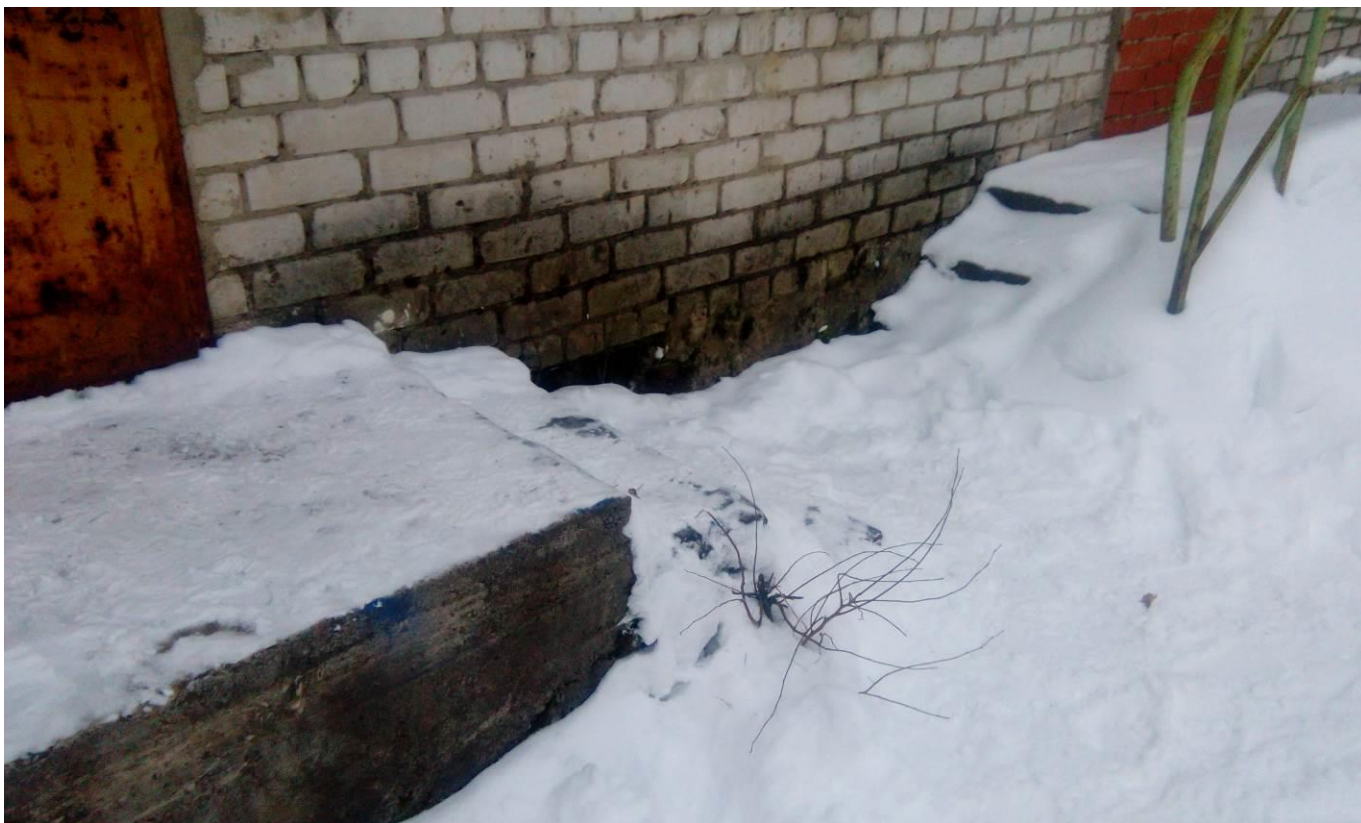
Фото 6. Замачивание цокольной части стены здания в осях 4-3/В.
