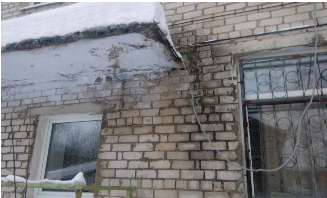
Фото 7. Замачивание цокольной части стены здания в осях 4-3/В. Разрушение бетонного козырька.
