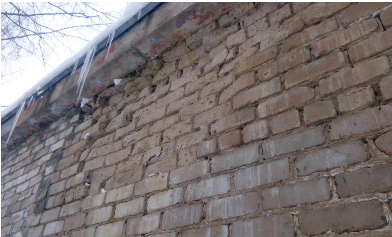
Фото 8. Разрушение кирпичной кладки стены на глубину до 50 мм.
