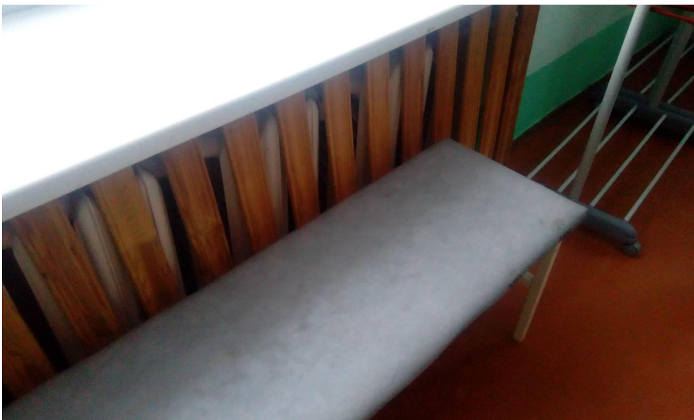
Фото 14. Отопительные приборы прикрыты деревянными щитами.
